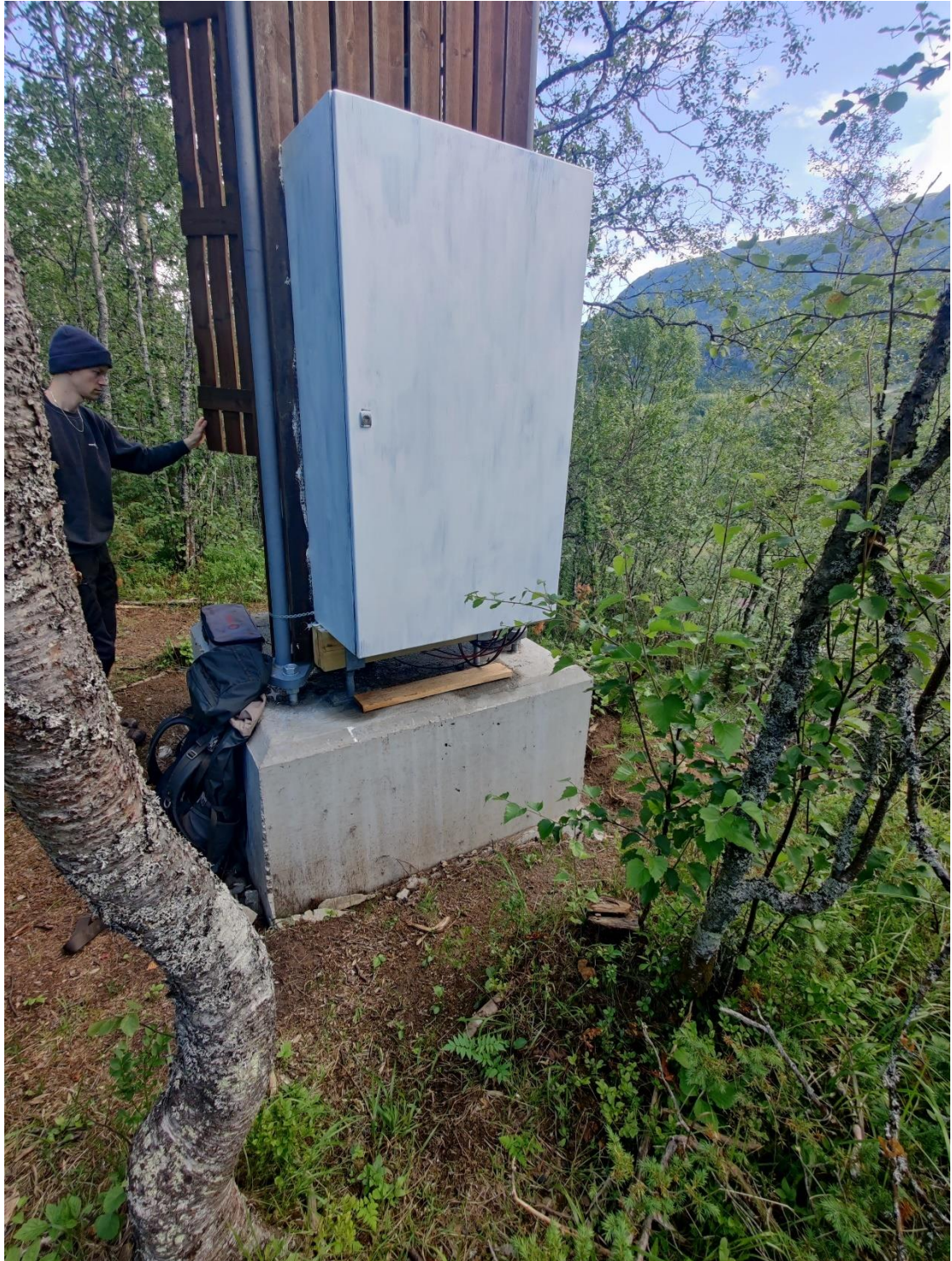
Mast er etablert med sokkel i betong, som er forankret ned i fast fjell. Det har vært fokus på å gå skånsomt frem i naturen.
