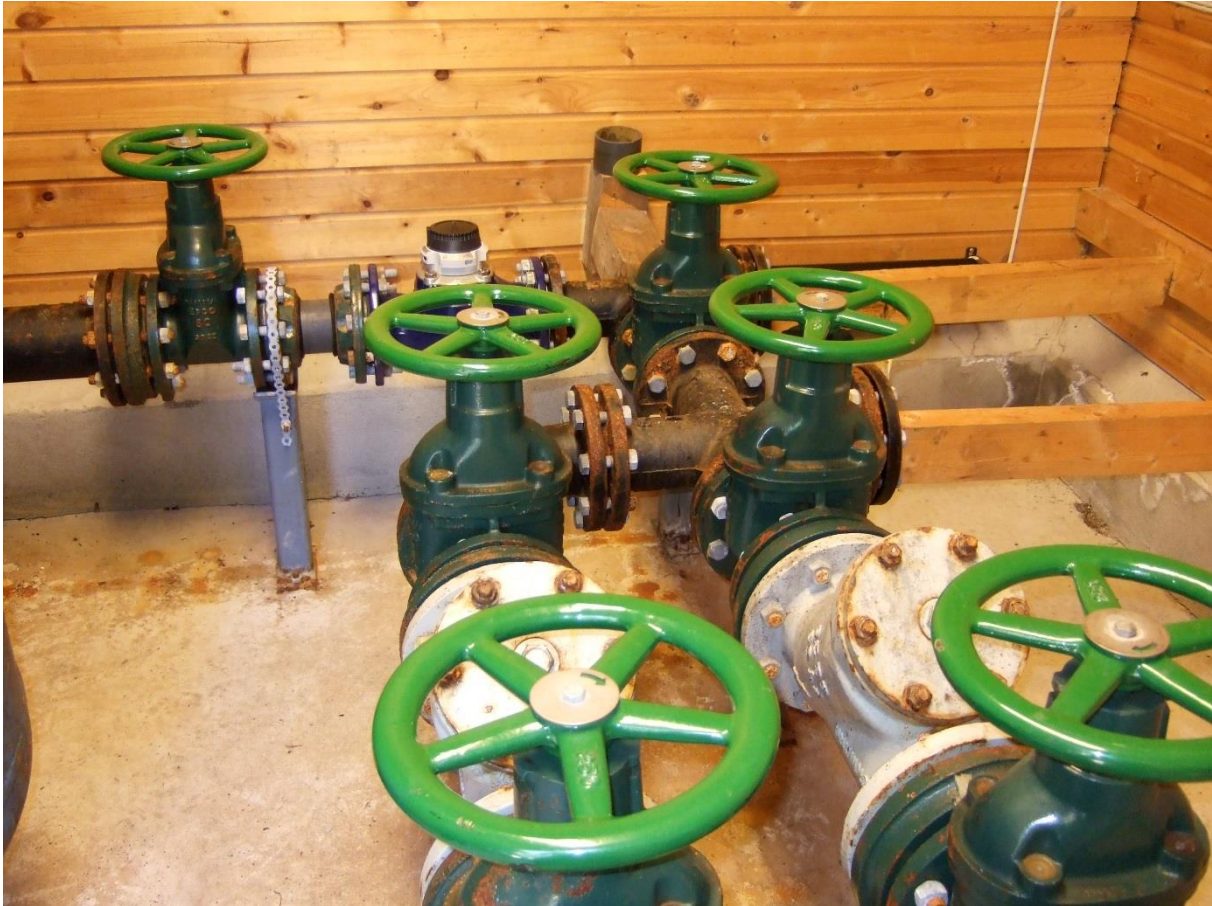
Figur 7 Bilde fra vannbehandlingsanlegg Kobbelveid Vannverk
