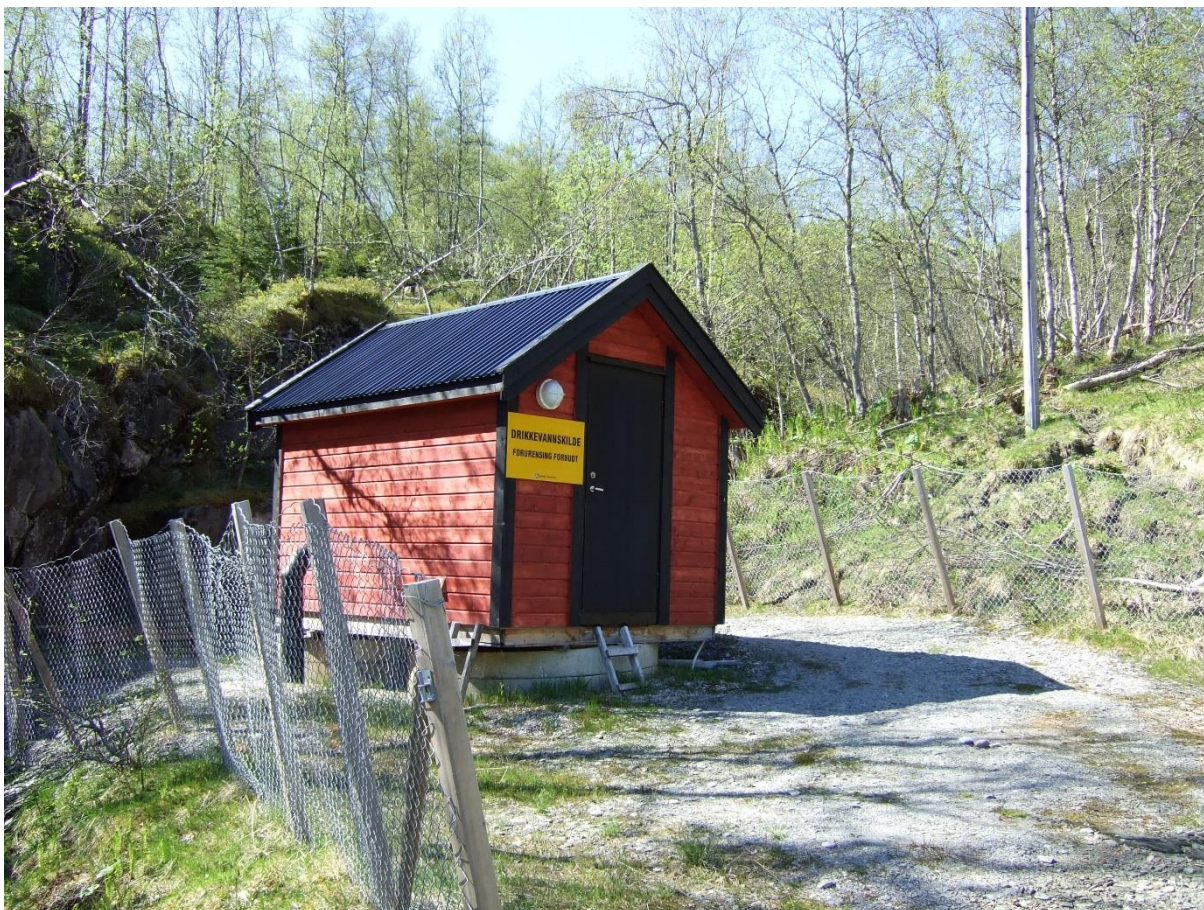
Figur 9 Elvkroken vannverk, vannbehandlingsanlegg
