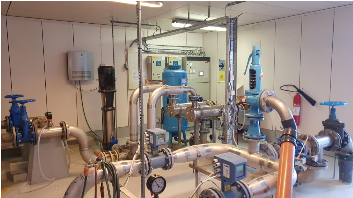
Figur 1 Straumen vannbehandlingsanlegg med UV-desinfeksjon
