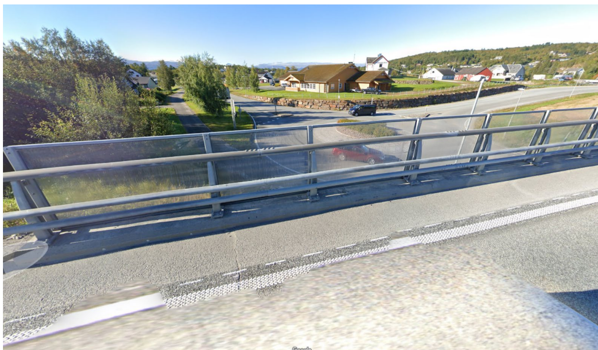
Figur 60: Flere rekkverksprodusenter har støyskjermer i glass som hektes på brurekkverket. Her fra Rv. 80 Strømsnes
