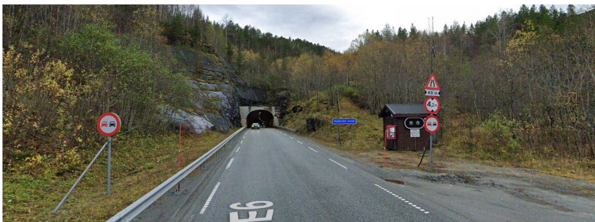
Figur 53: Tunnelene er smale og lave. Tekniske bygg og tunnelportaler tilfredsstill ikke kravene til funksjonalitet og arkitektur.
